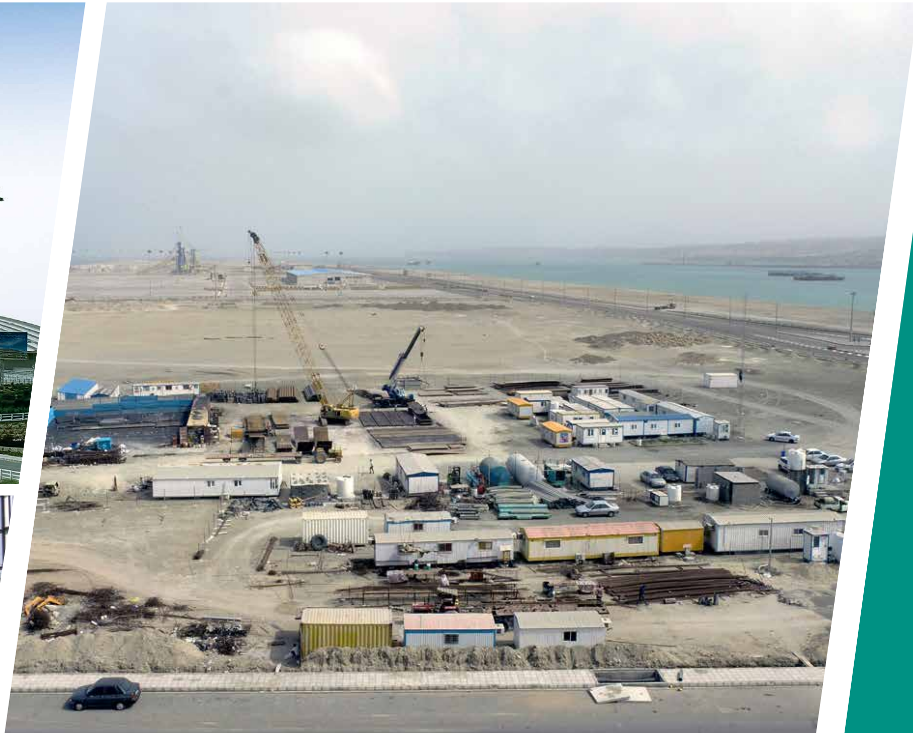
مجتمع ذخیره‌سازی قیر چابهار
